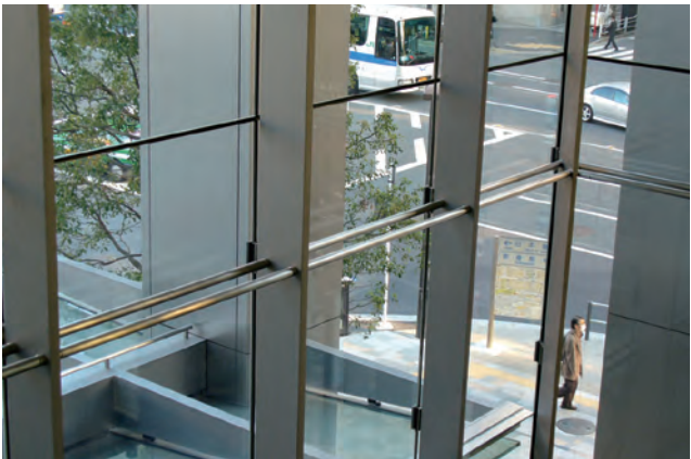
東京駅八重洲口サウスタワー ガラスカーテンウォール座屈止めロッド
