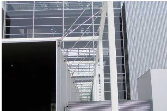
広島市中清掃工場 アルミハニカムパネル吊りロッド
